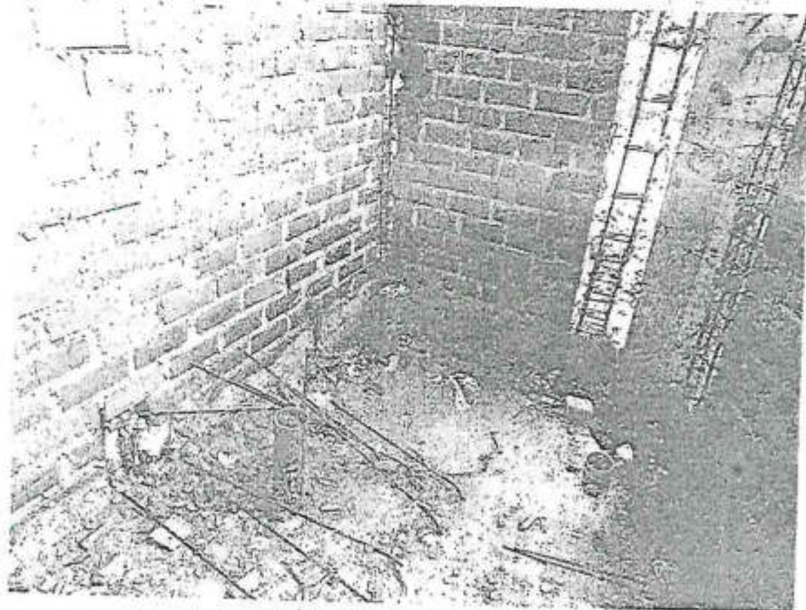
IMAGEN 5: Se nota los puntos de accesorios de los servicios higiénicos
