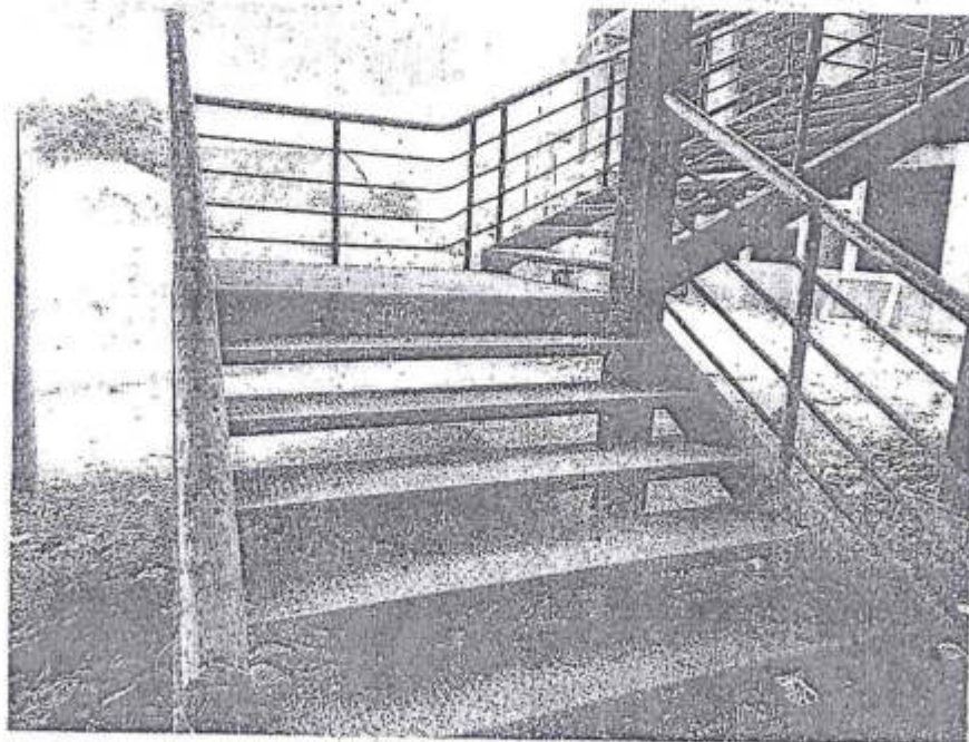
IMAGEN 7: Escalera metálica sin pintura anticorrosiva.
